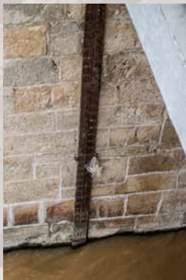
Medidor del nivel de las aguas en la pila 14ª. (Cortesía de Marta López García-17)
